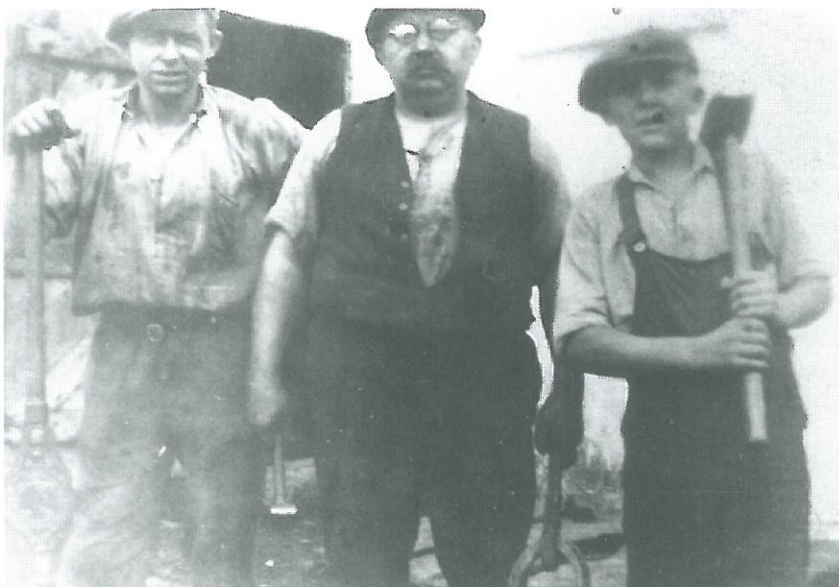
Nedgravningen af vandledninger gennem Snøde og Stoense blev blandt andet udført af dette seje sjak.
