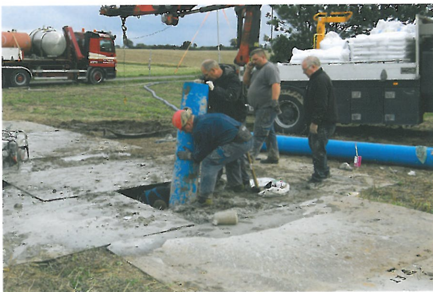
Snøde-Stoense Vandværk erstattede i 2012 den ene af borerne ved vandværket med en ny ved Klokkebanke vest for Lille Snøde.
