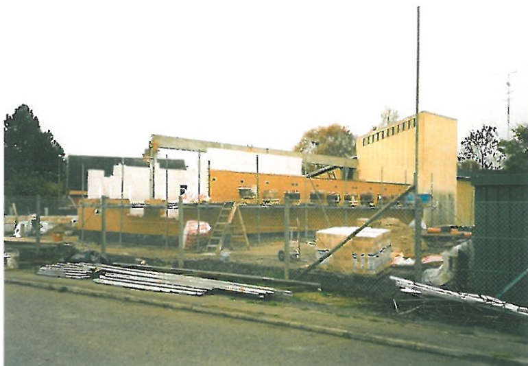
Da antallet af forbrugere steg og flere mindre vandværker bad om at blive forsynet fra Snøde var det nødvendigt at øge kapaciteten. Vandværket blev derfor udvidet i 2003.
